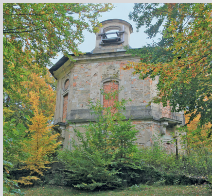
Das Hellhaus befand sich jahrzehntelang in einem beklagenswerten Zustand (Foto 2013).
